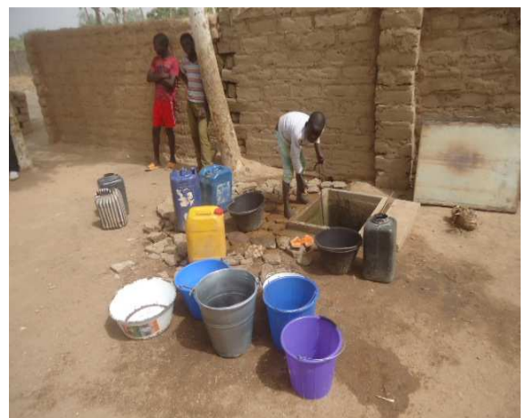
Figure 2 : Puits peu profond et pas couvert
